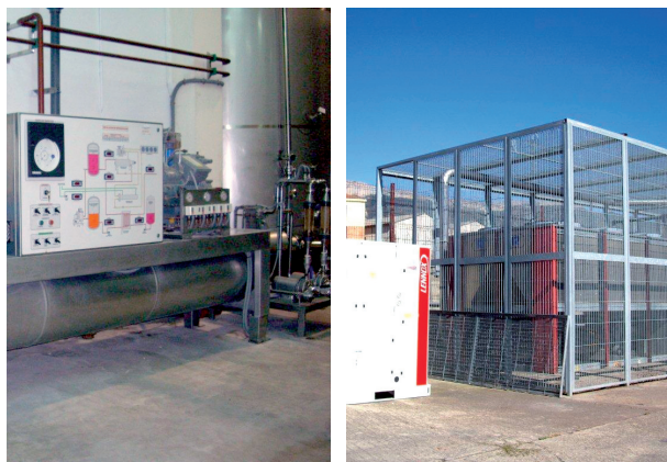
Ilustración 11. Equipos de frío
