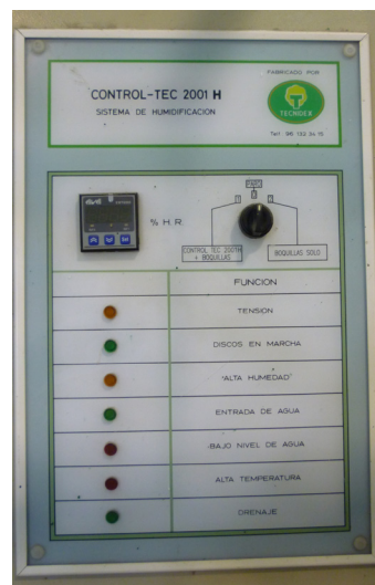
Ilustración 7. Panel de control de cámara de desverdización
